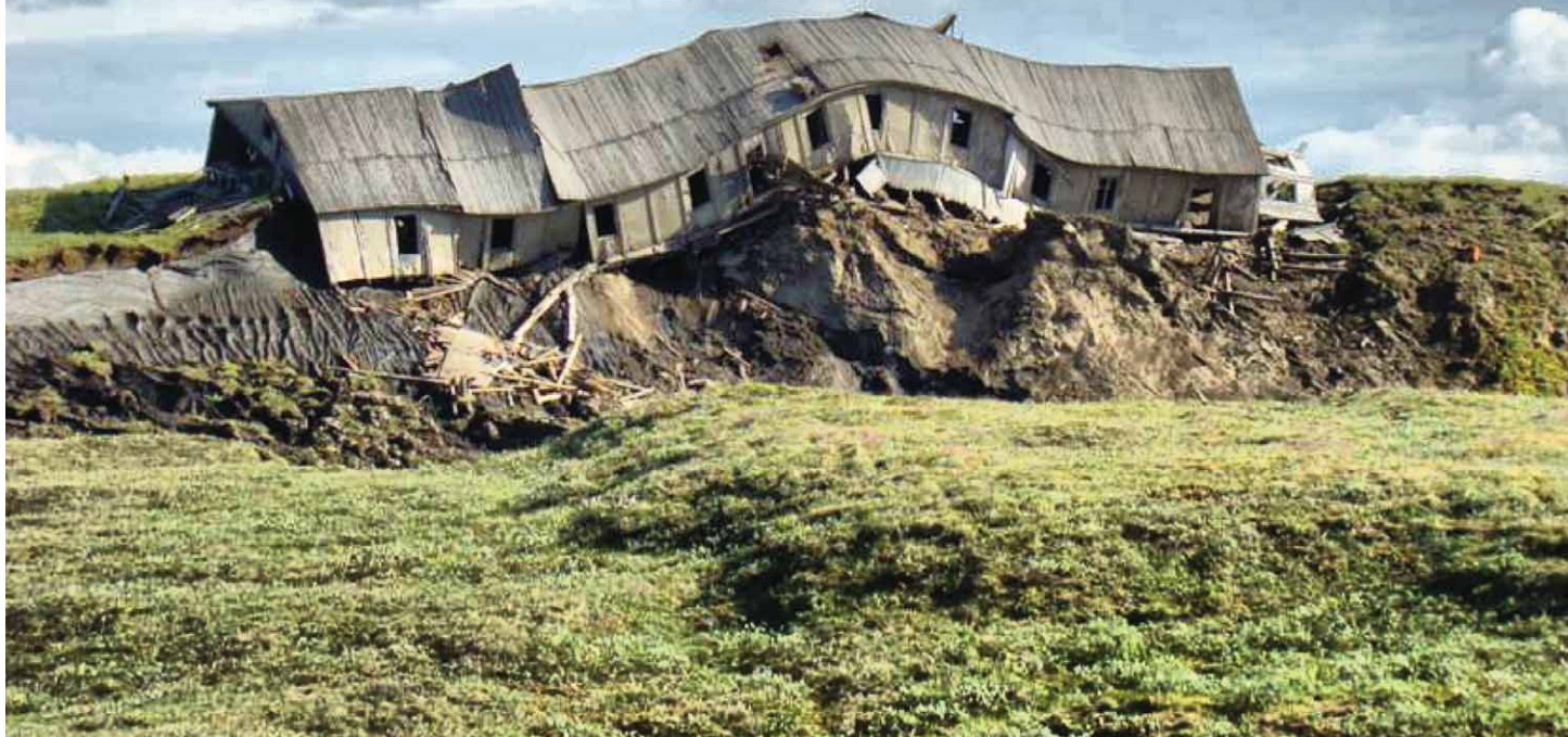
Деформация здания военной части в низовье Енисея за счет вытаивания подземного льда
